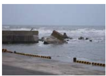
地震で損壊した堤防
